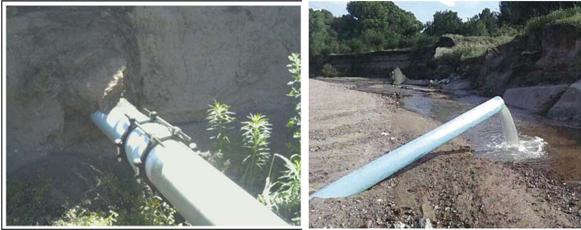
Figura 3 TUBERÍA DESCUBIERTA EN EL ARROYO POTRERO
